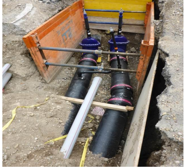
Einbindung einer Absperrarmatur
